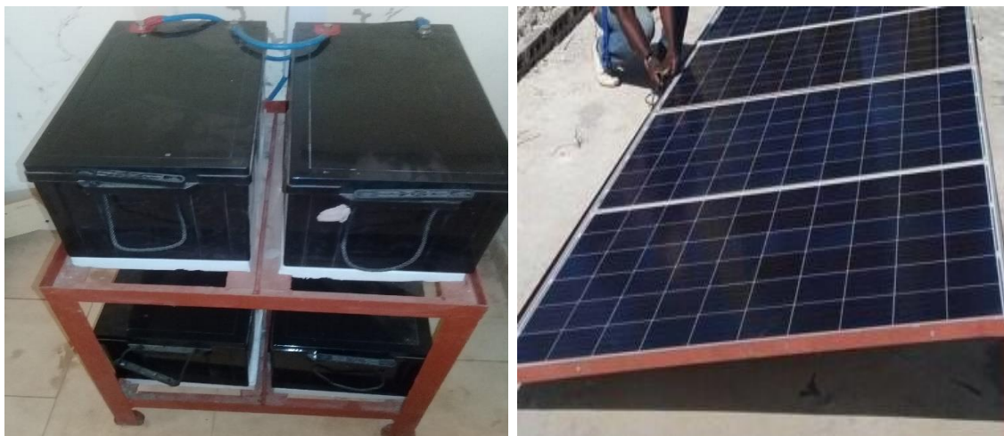
Planche de photos 3: Les batteries et les panneaux solaires qui fournissent la Mairie en électricité
